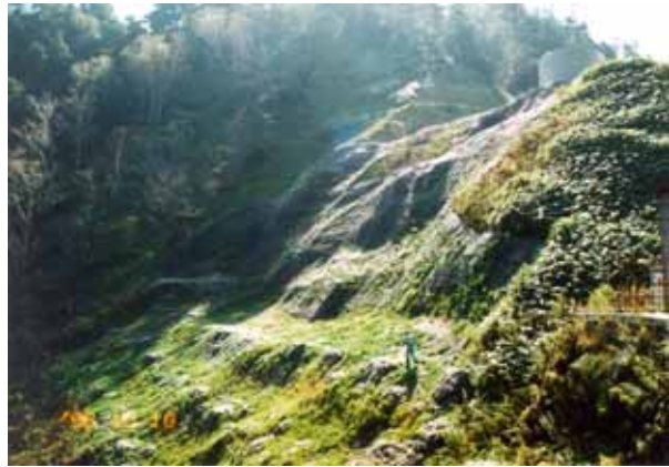
写真-2 1998年10月（施工後約1年） 施工1年後の法面全体の植被率は30%程度。特に急勾配部分は裸地が目立つ。
